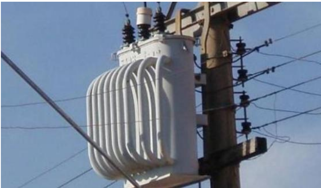
Figura 10 - Transformador de baixar tensão de corrente
