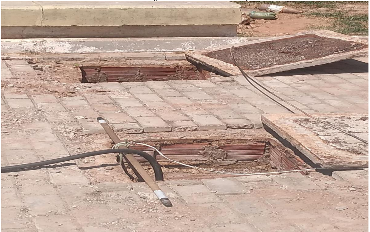
Figura 4 - Caixas da tubulação
