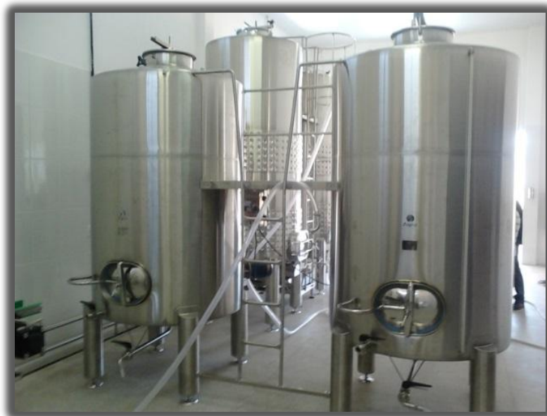
Figura 5. Tanque pulmão de armazenagem do suco na COANA, Petrolina-PE.
