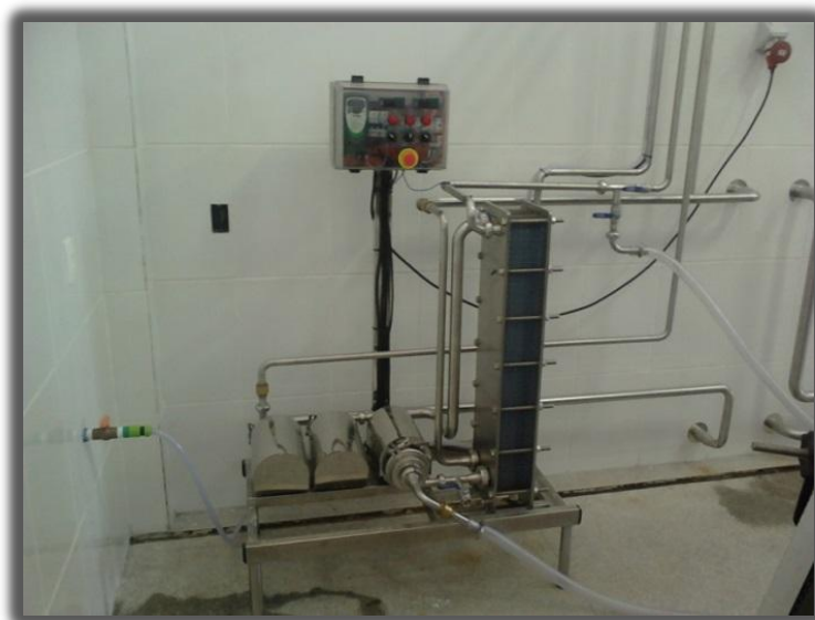
Figura 6. Pasteurizador tipo placas com controle de temperatura na empresa COANA, Petrolina-PE.
