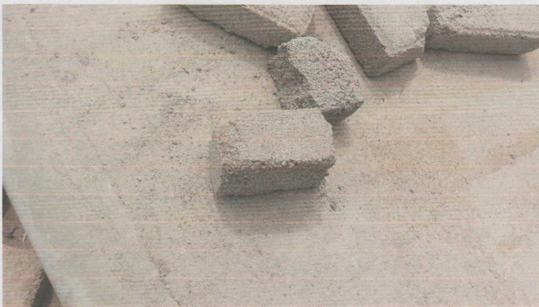
Figura-7 Bloco de concreto intertravado irregular da creche Cohab
