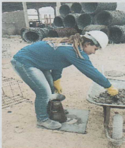
Figura 6 – Determinação da consistência pelo abatimento do tronco de cone Fonte: arquivo do Autor
